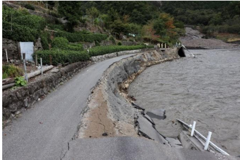
図8 台風19号による被害（令和元年10月11～14日）
