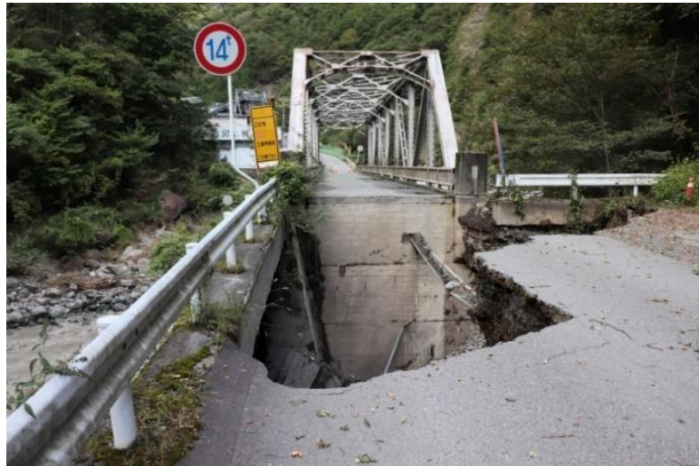
図9 台風19号による被害（令和元年10月11～14日）
