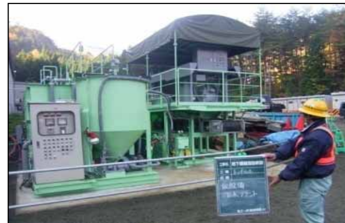
工事排水の処理装置
