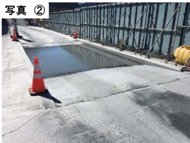
タイヤ洗浄設備の設置
