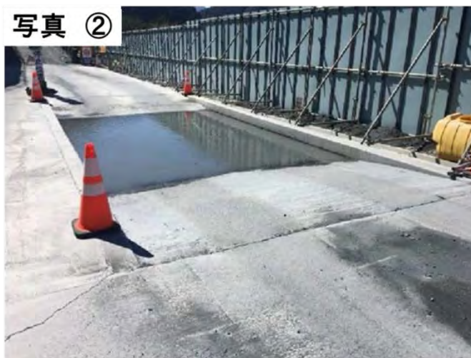
タイヤ洗浄設備の設置
