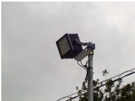
写真 4-1-2-17(3) LED 照明（早川非常口）
