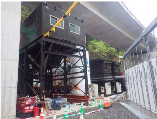
写真 4-1-1-9 濁水処理設備
