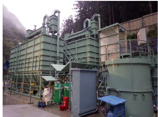
写真 4-1-2-10 濁水処理設備 (早川非常口)
