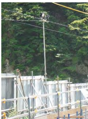
写真 4-1-2-17(1) LED 照明（点灯前） （早川非常口）
