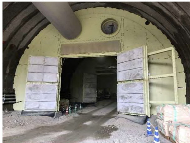
写真参 7-3-1 本坑防音扉 2 重構造
