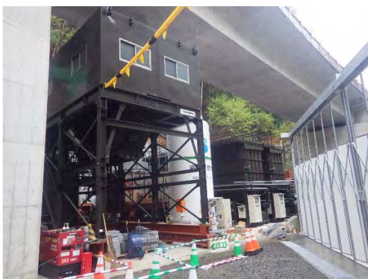
写真4-1-1-9 濁水処理設備
