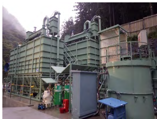
写真4-1-2-10 濁水処理設備 (早川非常口)
