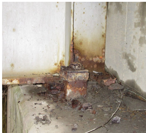
写真-2.2 支承の腐食、防食機能の劣化
