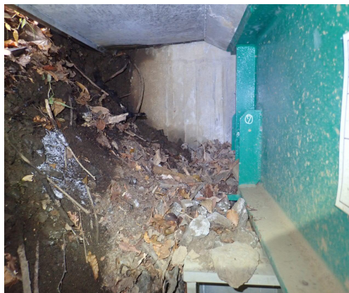
写真-2.4 支承部の土砂詰り
