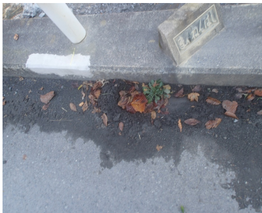
写真-2.3 排水ますの土砂詰り
