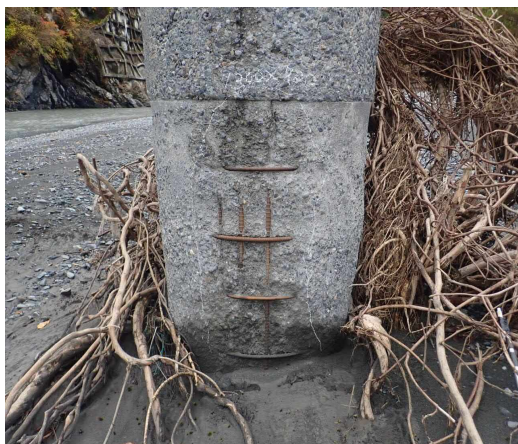
写真-2.1 橋脚の剥離・鉄筋露出
