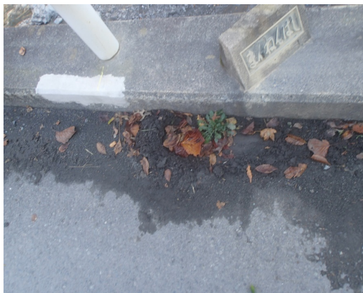
写真-2.3 排水ますの土砂詰り
