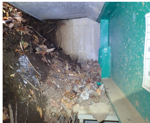
写真-2.4 支承部の土砂詰り
