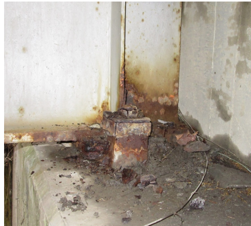
写真-2.2 支承の腐食、防食機能の劣化
