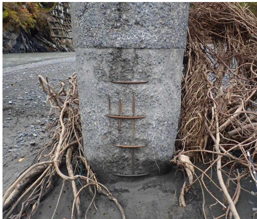
写真-2.1 橋脚の剥離・鉄筋露出
