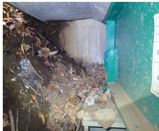
写真-2.4 支承部の土砂詰り
