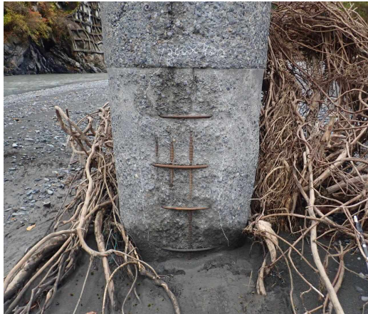
写真-2.1 橋脚の剥離・鉄筋露出
