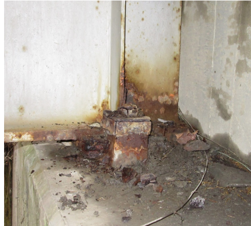
写真-2.2 支承の腐食、防食機能の劣化
