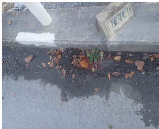
写真-2.3 排水ますの土砂詰り
