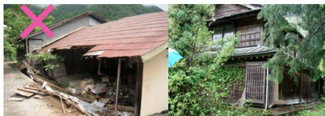
傷みの激しい空き家、建物周囲の雑草や蔓などは、防災防犯、獣害誘発など生活上の不安材料となる。
