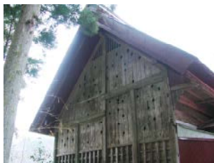
お宮の建物が傷んでいる
