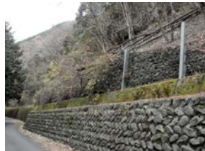
フェンスを破りそうな土砂
